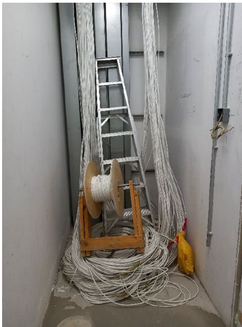
Εικόνα 4-7 Εσωτερικό του IT/ELV Δωματίου
