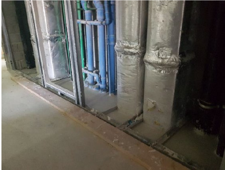
Εικόνα 5-4 Χώρος υπηρεσιών (Risers) στους διαδρόμους
