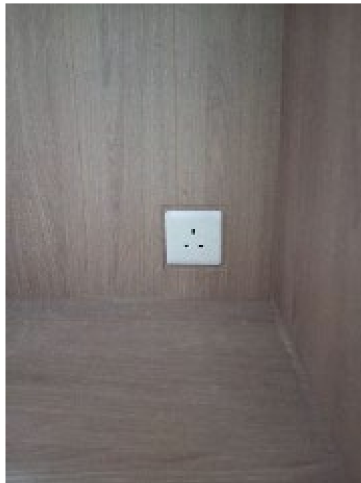
Εικόνα 5-7 Εγκατάσταση πριζών στους διάδρομους των δωματίων σε ερμάρι
