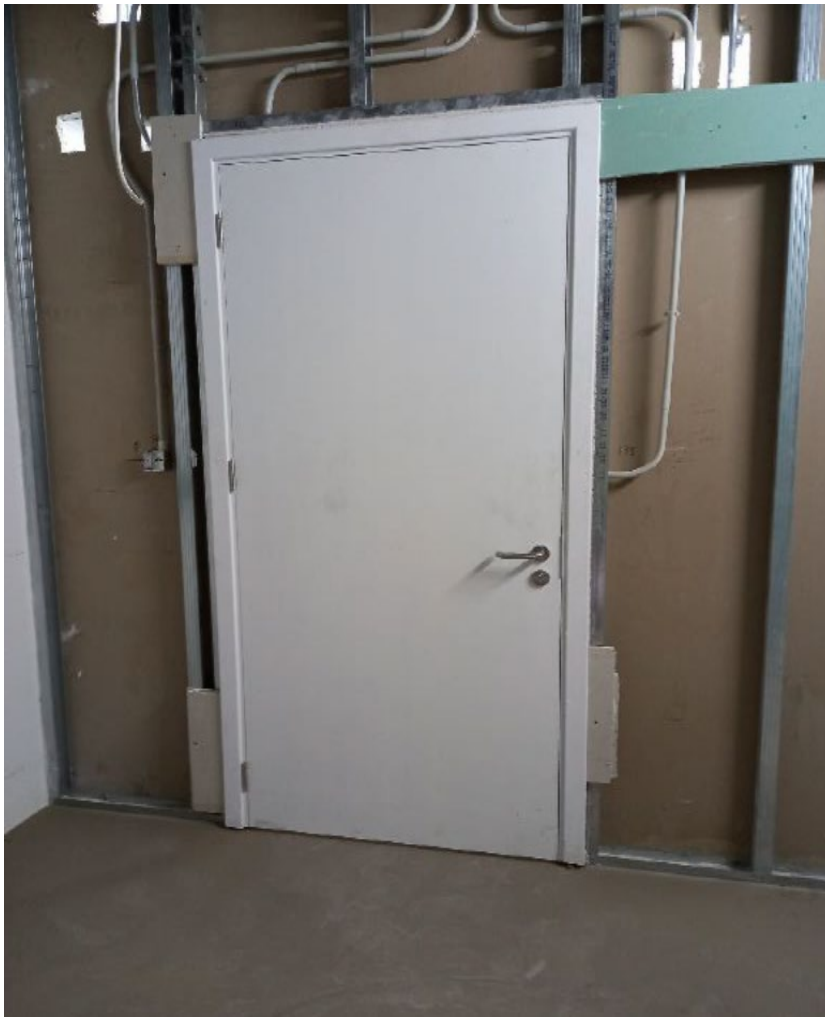
Εικόνα 4-8 Προσωρινή πόρτα για προστασία του IT/ELV δωματίου
