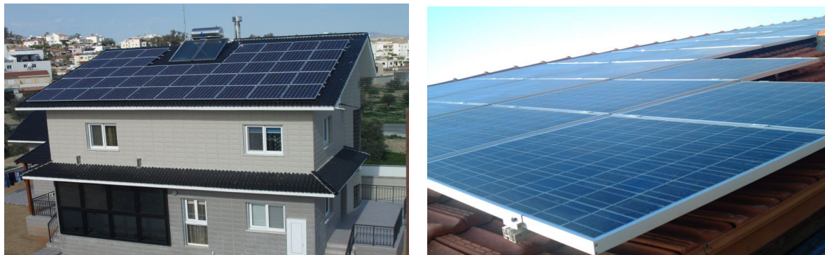
Εικόνα 2.1 Ηλιακά Φ/Β πλαίσια προσαρτημένα στην οροφή του σπιτιού
