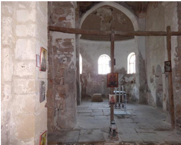
Εικόνα 6α : Το Ιερό του ναού χωρίς το εικονοστάσι μετά τη σύληση Πηγή: Παρασκευή Ιωάννου, 2020)
