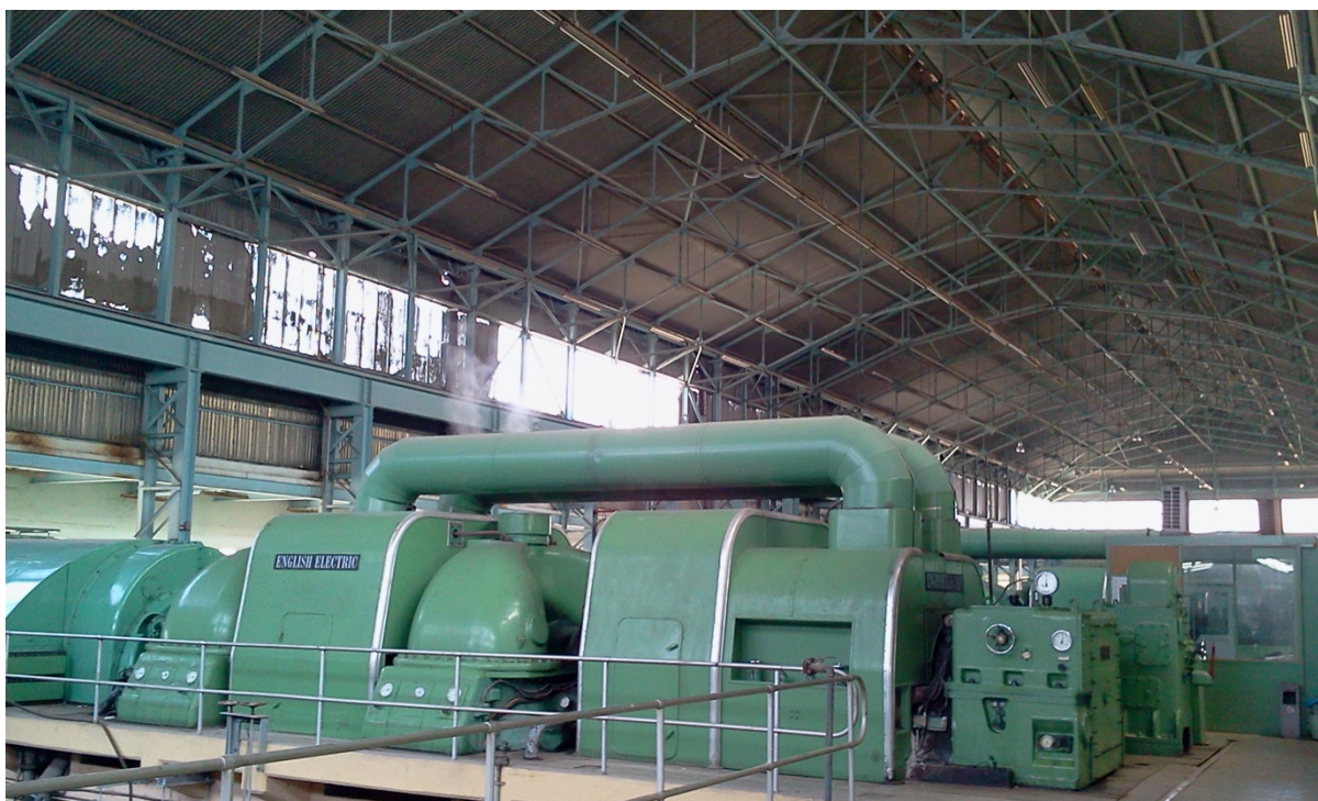
Εικόνα 2.11: Ο ηλεκτροπαραγωγικός σταθμός Βασιλικού (Πηγή: Αρχή Ηλεκτρισμού Κύπρου 2020)
