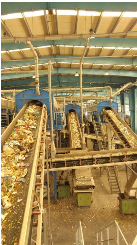
Εικόνα 4.2: Διαχωρισμός ΑΣΑ στο σταθμό ΧΥΤΥ (η φωτογραφία λήφθηκε για σκοπούς του εν λόγω μεταπτυχιακού προγράμματος)
