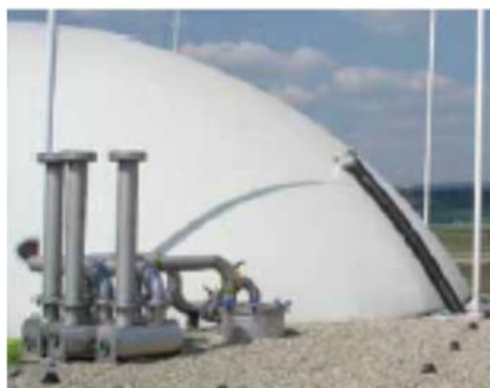
Εικόνα 3.11 Εγκαταστάσεις πίεσης και βαλβίδες ασφαλείας (AGRINZ 2006)
