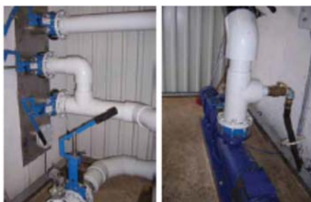
Εικόνα 3.3 Βαλβίδες διακοπής (αριστερά) και σύστημα άντλησης (δεξιά) (RUTZ 2006)
