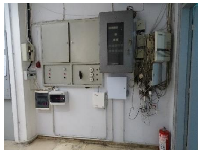
Φωτογραφία 44 Πίνακες, παλιό τηλεφωνικό κέντρο
