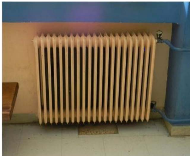
Εικόνα 7: Τυπικό θερμαντικό σώμα στο κτήριο
