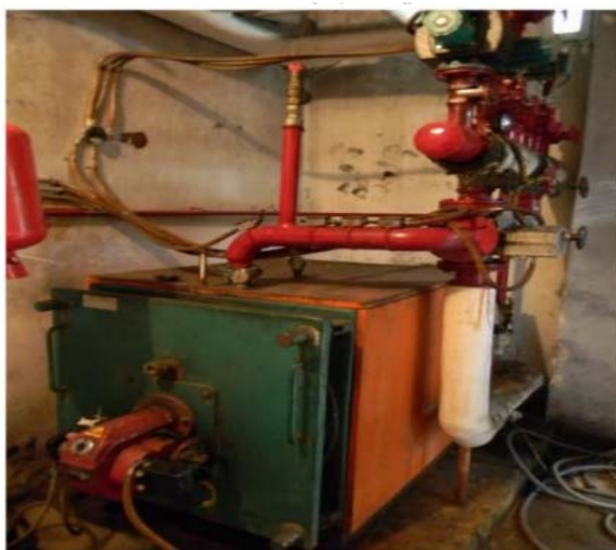
Εικόνα 6: Λέβητας 5 ου Δημοτικού Σχολείου Σερρών
