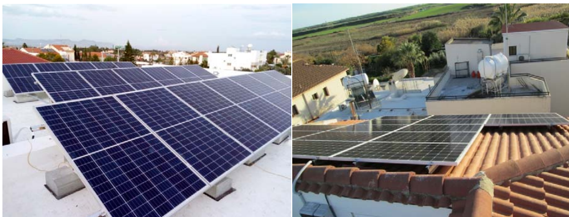
Figure 13: Διασυνδεδεμένο Φ.Β Σύστημα Συμψηφισμού Μετρήσεων σε επίπεδη οροφή και κεραμοσκεπή
