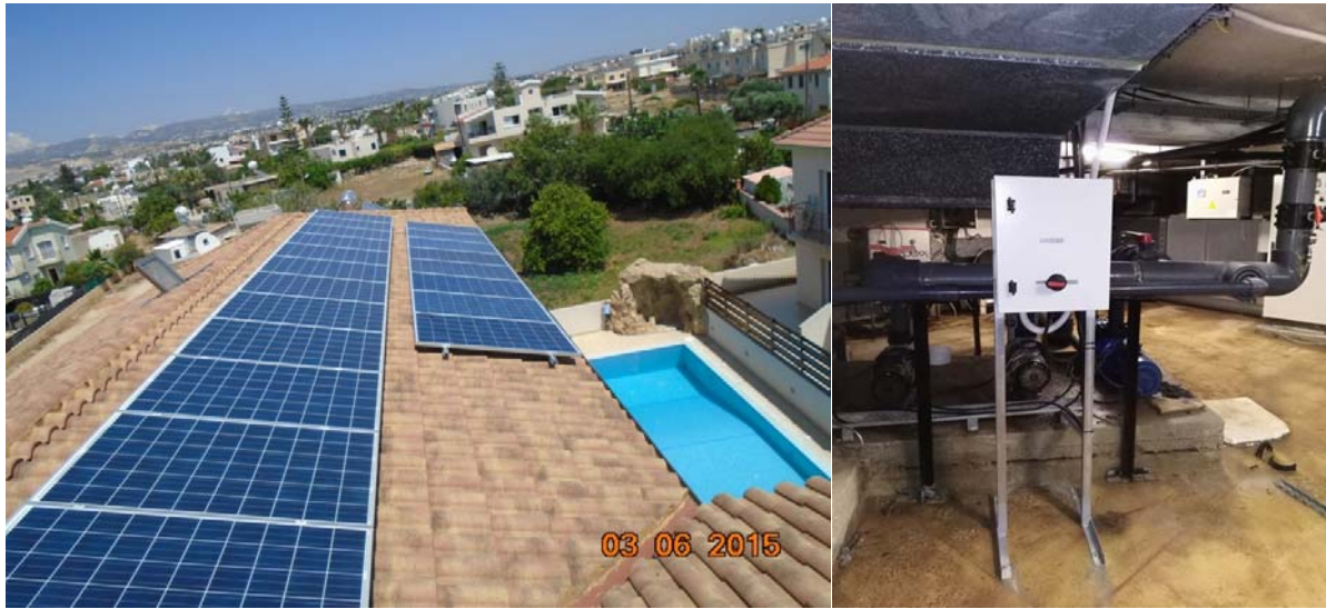
Figure 11: Αυτόνομο συστήματα Ανακύκλωσης Νερού Πισίνας
