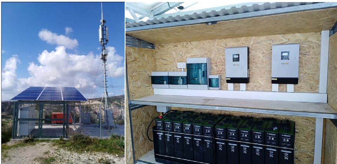
Figure 7: Αυτόνομο Φ.Β σύστημα Ηλεκτροδότησης Αντενών Κινητής Τηλεφωνίας
