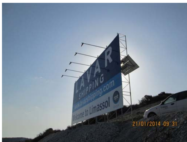
Figure 9: Αυτόνομο σύστημα Φωταγώγησης (Φ.Β Πινακίδα)
