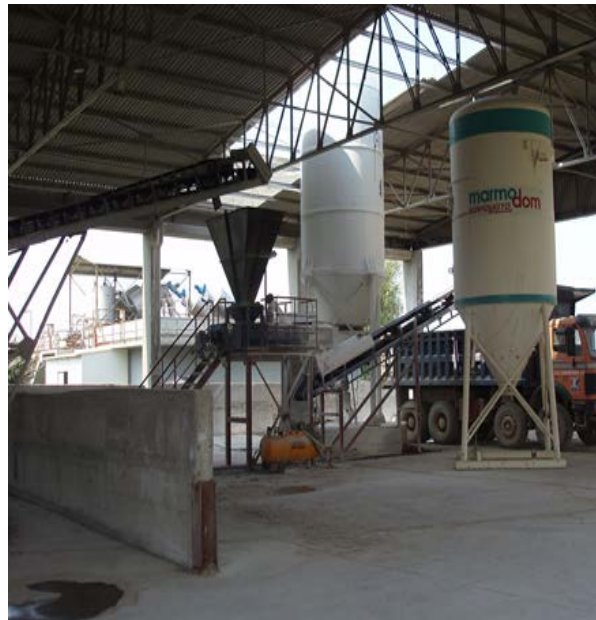
Σιλό αποθήκευσης – τροφοδοσίας ασβέστη
