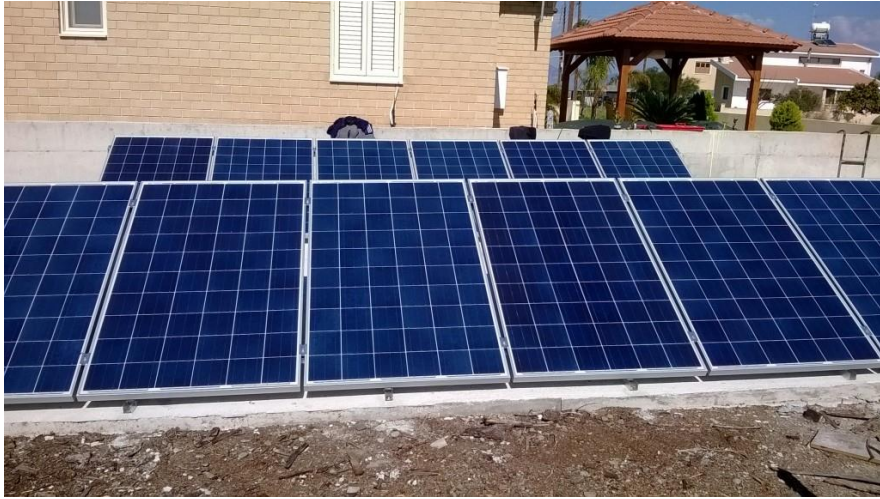
Εικόνα 20: Φωτοβολταϊκό σύστημα 3 kWp στο έδαφος δίπλα από νόμιμα υφιστάμενη κατοικία στο Παλιομέτοχο Λευκωσίας, Gesolar Cyprus Ltd 2014
