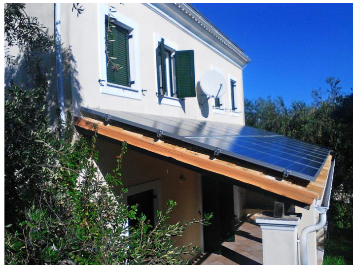
Εικόνα 23: Φωτοβολταϊκό σύστημα 8,64 kWp σε στέγη βεράντας σε οικία στη Κέρκυρα από την ελληνική εταιρεία eshop energy, 2015
