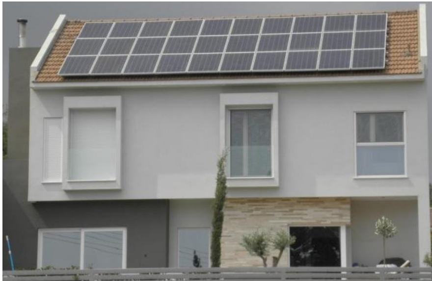
Εικόνα 21: Φωτοβολταϊκό σύστημα 7,35 kWp σε κεκλιμένη στέγη σε οικία στο Ψευδά Λευκωσίας, Gesolar Cyprus Ltd 2014
