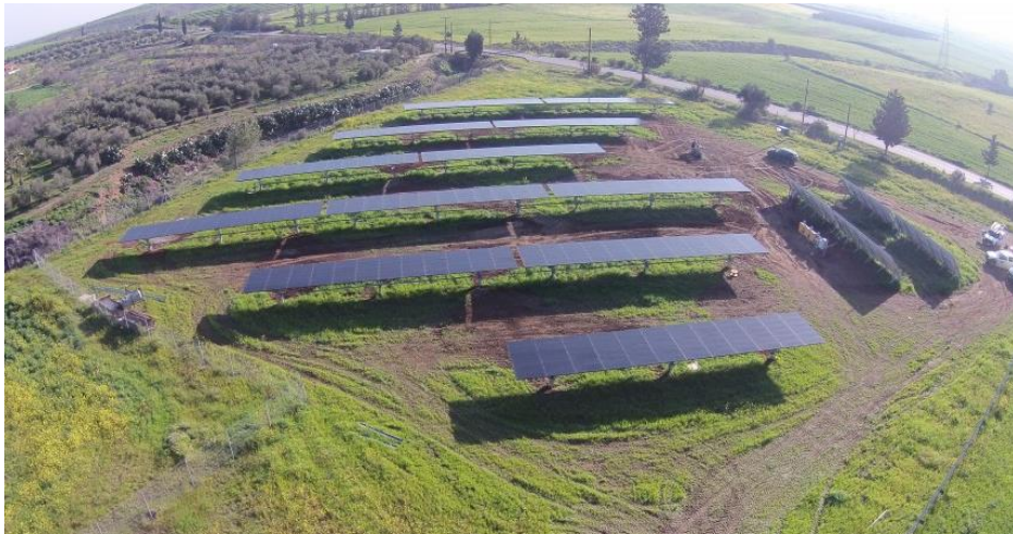
Εικόνα 18: Φωτοβολταϊκό πάρκο δυναμικότητας 150kWp στην περιοχή Κουτραφάς στη Λευκωσία, Gesolar Cyprus Ltd 2014
