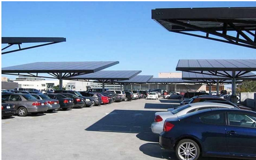
Εικόνα 25: Φωτοβολταϊκά πλαίσια σε χώρο στάθμευσης σε στέγαστρα σε νοσοκομείο της Καλαμάτας, Πέννυ Μ, 2014
