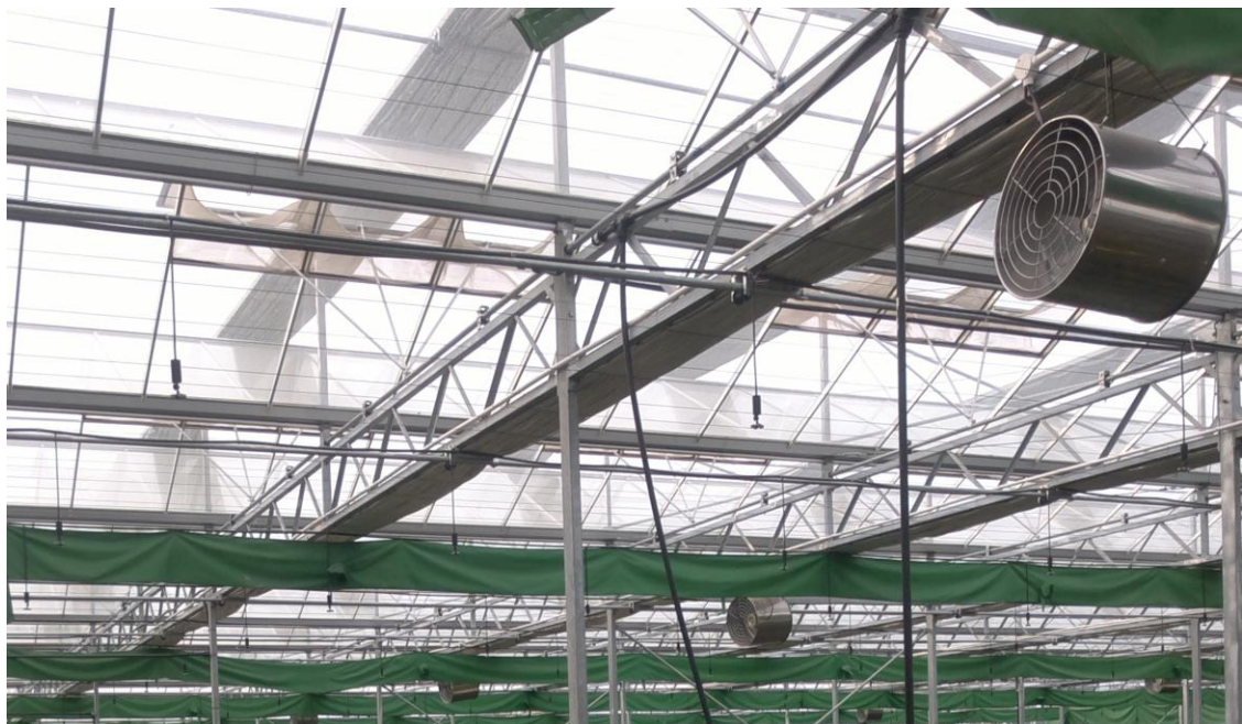
Εικόνα 33: Φωτογραφία από το εσωτερικό του θερμοκηπίου στην οποία φαίνονται οι ηλεκτρικοί ανεμιστήρες
