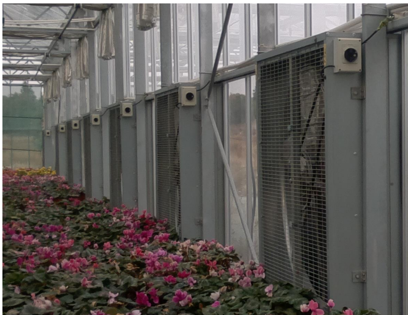
Εικόνα 35: Φωτογραφία από το εσωτερικό του θερμοκηπίου στην οποία φαίνονται τα ηλεκτρικά συστήματα ψύξης - κλιματισμού
