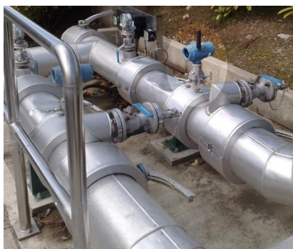
Εικόνα 42 Συσκευές πεδίου (field devices) που τοποθετήθηκαν σε σωλήνες που μεταφέρουν νερό για να εκτελέσουν διάφορες μετρήσεις.
