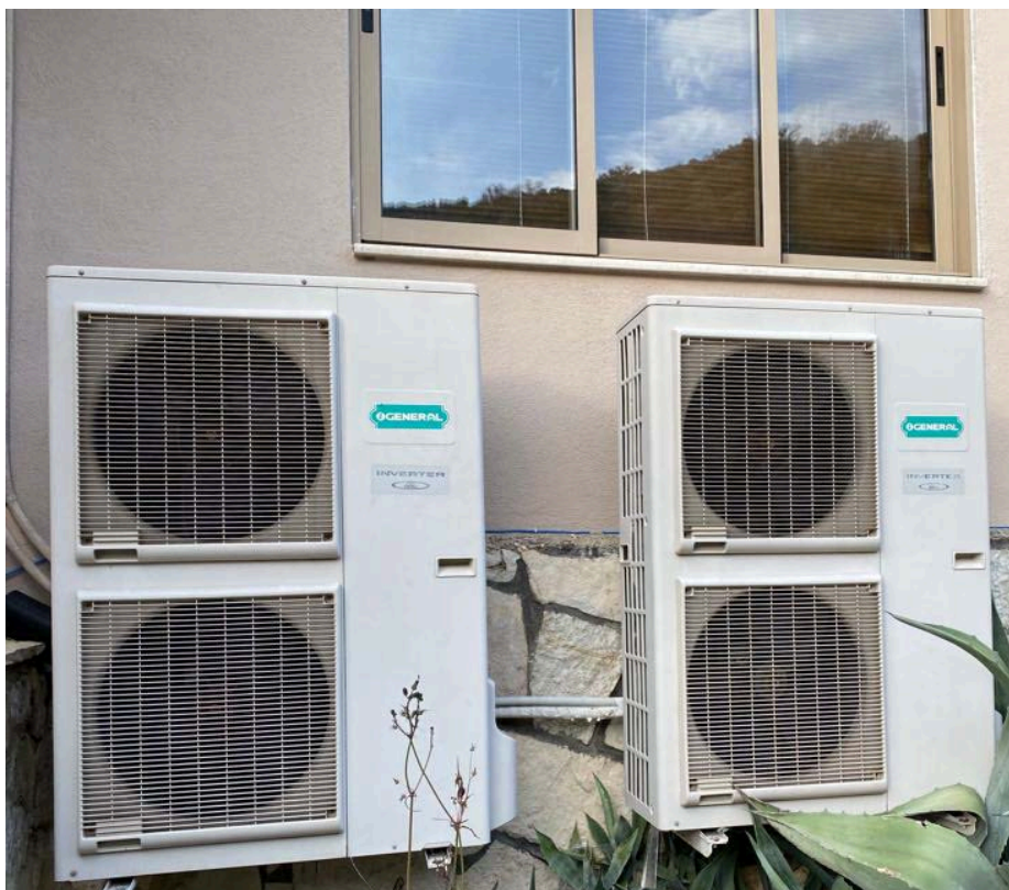
Εικόνα 24: Εξωτερικά Κλιματιστικά ξενοδοχείου
