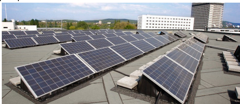
Εικόνα 37. Φωτοβολταϊκά Πανέλα στις οροφές κτιρίων
