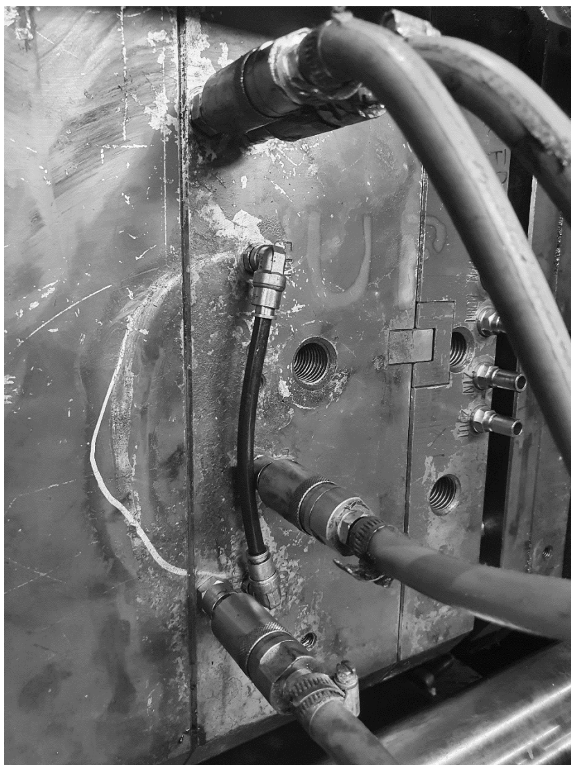
Σχήμα 39: Εγκατεστημένοι ελαστικοί σωλήνες με ταχύ-συνδέσμους
