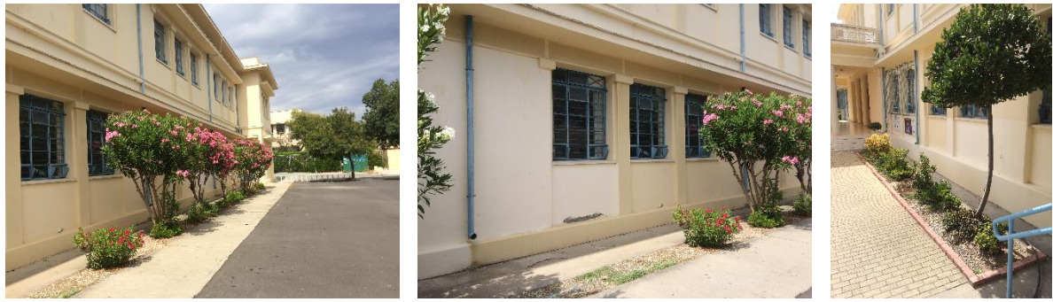
Εικόνα 5.11: Υδρορροές που καταλήγουν σε αδιαπέρατο δάπεδο, ενώ ακριβώς μπροστά σε αυτές υπάρχει λωρίδα πρασίνου που θα μπορούσε να παραλάβει το νερό αυτό.
