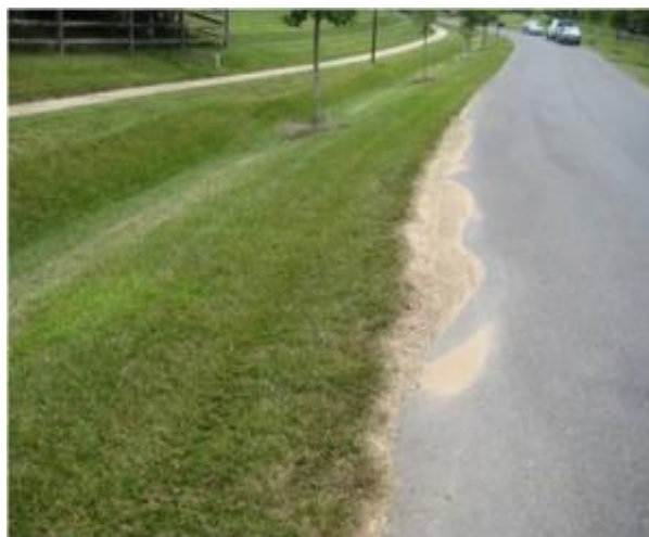
Εικόνα 4.23: Μία λωρίδα φιλτραρίσματος δίπλα από δρόμο. Παρατηρούμε ότι στο κάτω μέρος καταλήγει σε αυλάκι. Πηγή (Chesapeake Stormwater Network 2016).
