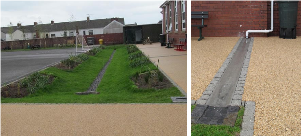
Εικόνα 5.14: Παράδειγμα από εγκατάσταση σε δημοτικό σχολείο στο Stebonheath, στο Ηνωμένο Βασίλειο. Πηγή (Sudsdrain 2012a)
