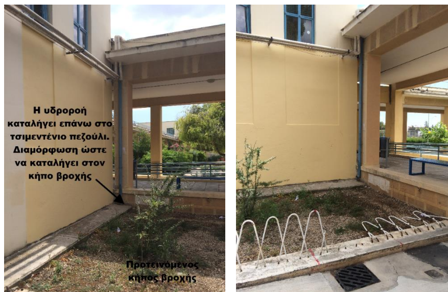
Εικόνα 5.13: Υδροροή που καταλήγει σε πεζούλι δίπλα από χώρο πρασίνου. Προτείνεται η διαμόρφωση του χώρου αυτού σε κήπο βροχής και η διαμόρφωση όλων των
