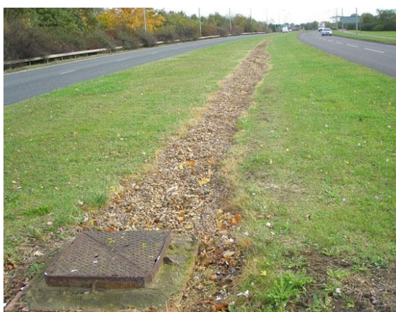
Εικόνα 4.36: Τάφρος διήθησης σε κύριο δρόμο στο Ηνωμένο Βασίλειο. Πηγή (Yu 2013).
