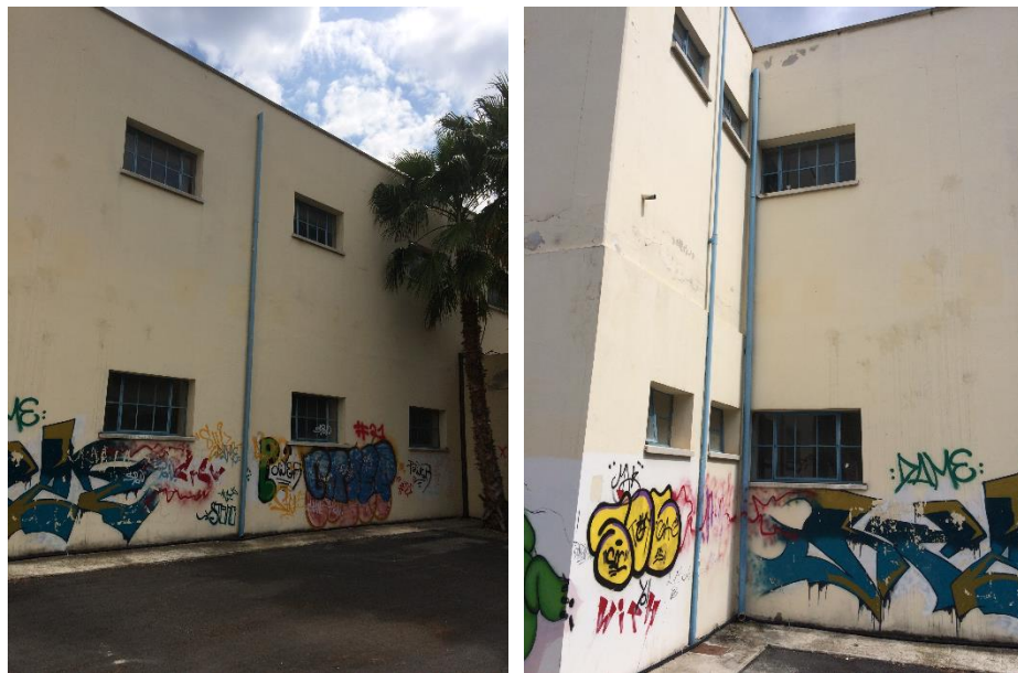
Εικόνα 5.4: Υδρορροές που καταλήγουν σε αδιαπέρατες επιφάνειες.
