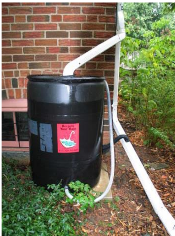
Εικόνα 5.1: Βαρέλι βροχής συνδεδεμένο με υδρορορή. Πηγή (Authority & Credit Valley Conservation Authority 2010).
