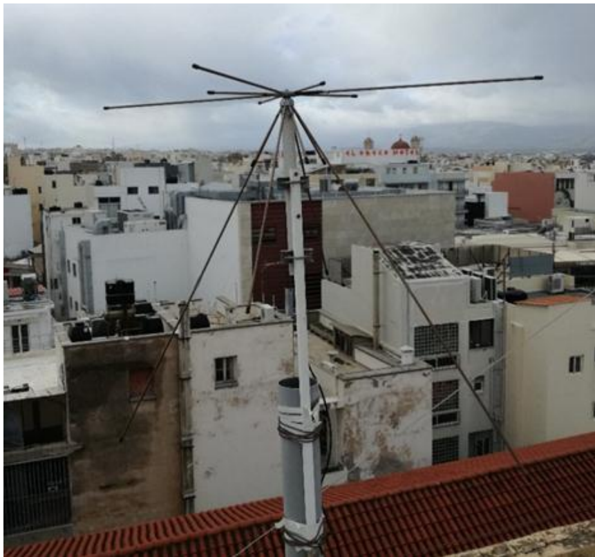
Εικόνα 3.7: Δισκωνική Κεραία κατασκευασμένη από μεταλλικές ράβδους για ευρυζωνική λήψη στη ζώνη των VHF ως κεραία λήψης σε δέκτη Radio Scanner (Τεχνική Υπηρεσία Δήμου Ηρακλείου Κρήτης - κτήριο Ανδρόγεω)
