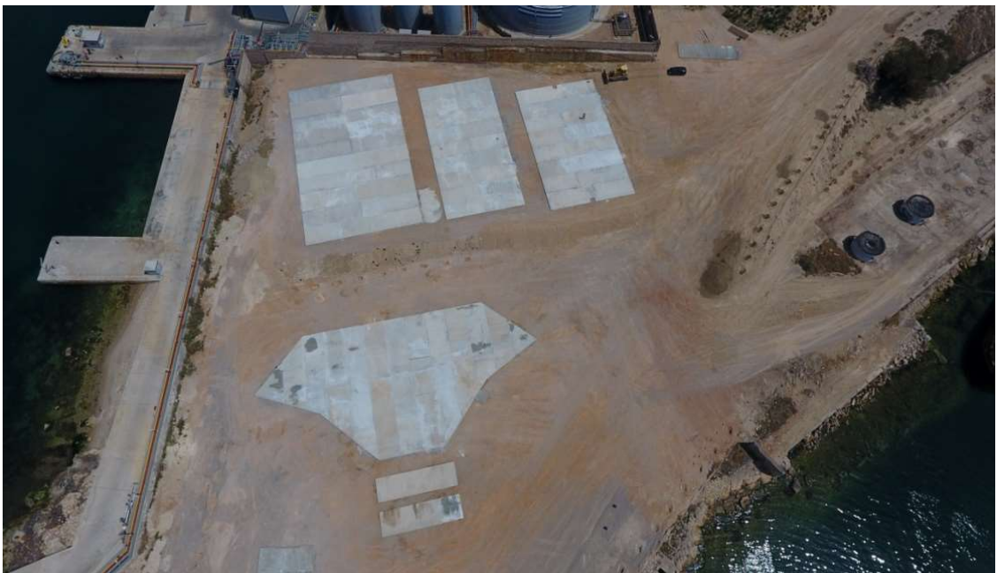
Εικόνα 42: Η εξέλιξη των εργασιών (δημιουργία 3 γηπέδων ποδοσφαίρου 5x5, μπάσκετ και τένις και 1 θεάτρου με εξέδρες, παρασκήνια, τουαλέτες, κ.α.) του Δήμου Κερατσινίου-Δραπετσώνας στην περιοχή Φωτογραφία από Drone
