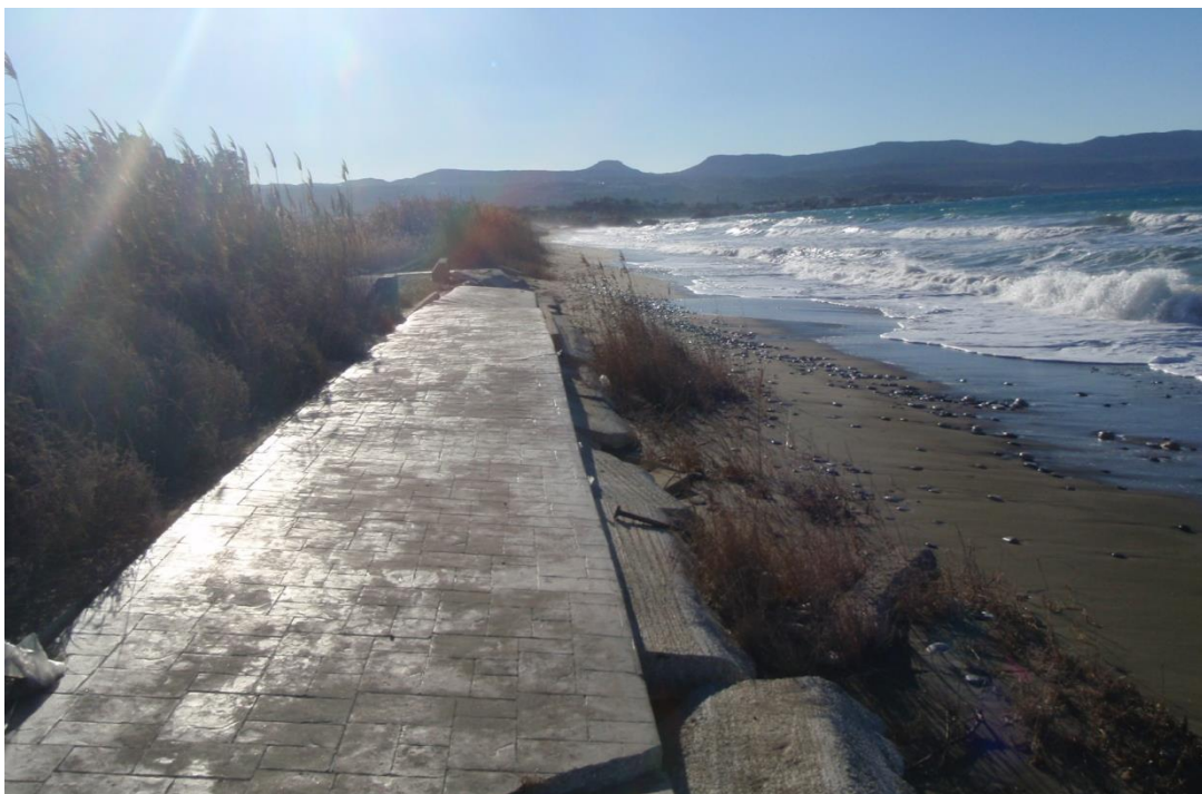
Εικόνα 3.15: Υφιστάμενη κατάσταση παραλιακού πεζόδρομου στην περιοχή κατασκηνωτικού χώρου Πόλη Χρυσοχούς όπου διακρίνονται οι ζημιές που έχει υποστεί λόγω διάβρωσης
