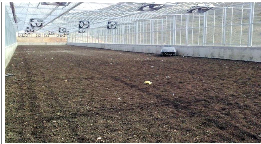
Εικόνα 10. .Ηλιακη ξήρανση λυματολάσπης στην εγκατάσταση του ΧΥΤΑ Χερσονήσου.
