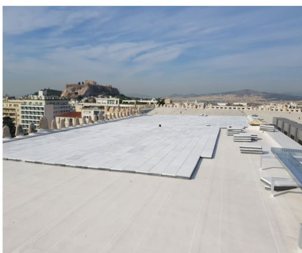
Εικόνα 4 – 1 Υλικό της Ravago σε στέγη (Βουλή)
