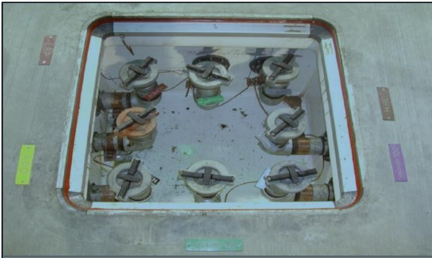
Εικόνα 2: Φρεάτιο απομακρυσμένης πλήρωσης δεξαμενών (offset filling)
