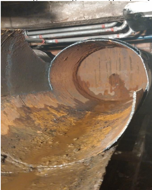
Εικόνα 9.6 : Κτήριο Β . Θερμοδοχείο που αποξηλώθηκε από την εγκατάσταση . Έγινε πλήρης τεμαχισμός των παλαιών θερμοδοχείων (Πηγή : ΠΥΡΑΜΙΣ ΑΤΕ)
