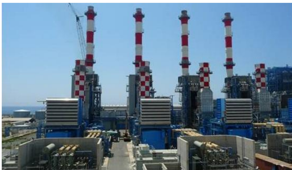
Εικόνα 13: Ηλεκτροπαραγωγός Σταθμός Βασιλικού
