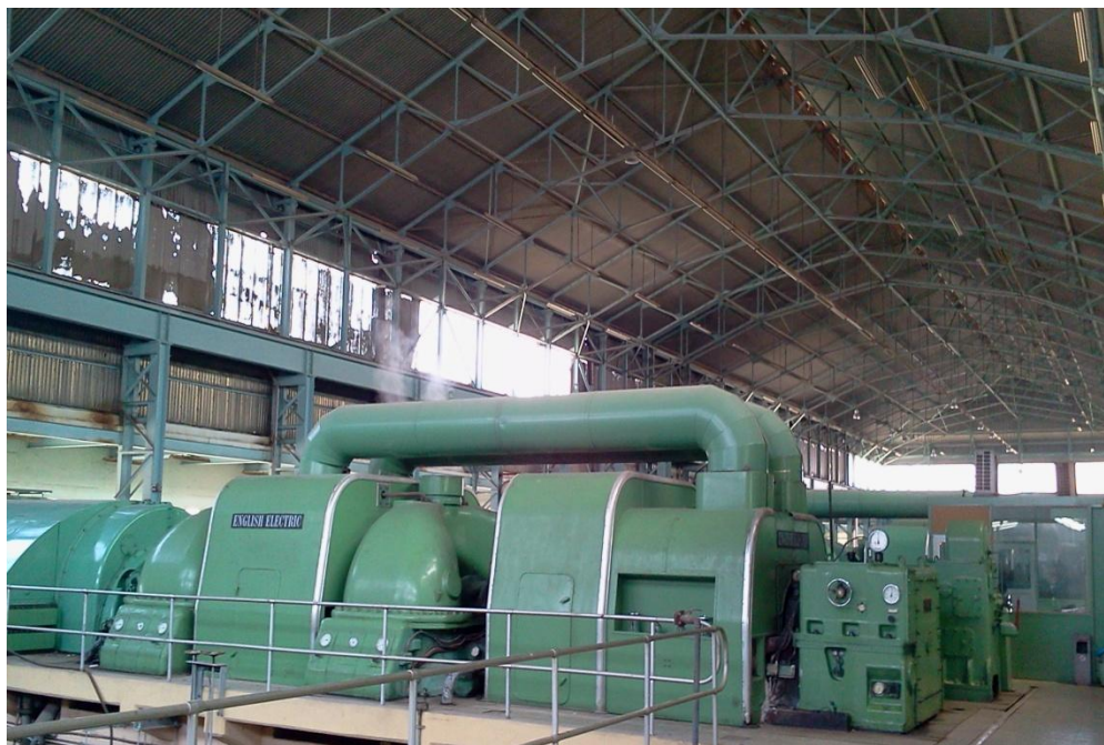
Εικόνα 15: Μονάδα Ισχύος στον Ηλεκτροπαραγωγό Σταθμό Μονής
